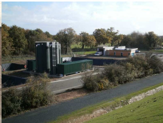
Au premier plan, l'unité de traitement des lixiviats, et, au second plan, le bâtiment administratif.
