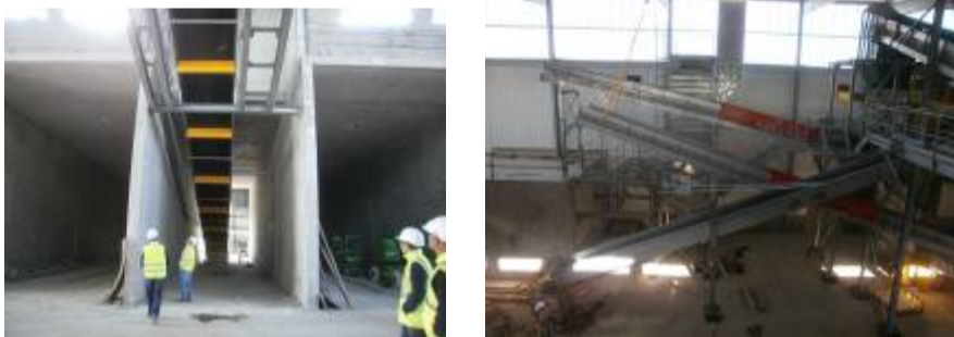
De gauche à droite : le grand convoyeur à bande reliant la fosse de sortie des tubes à la trémie d'alimentation du crible primaire. Le réseau de convoyeurs à bandes permettant de relier et d'alimenter les différents organes de la chaîne de tri du futur compost ; en arrière plan, le filtre à manche permettant la séparation aéroulque des refus légers.
