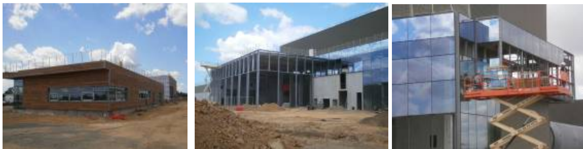
De gauche à droite : le bâtiment administratif habillé de bardage bois ; le hall de réception des déchets avec les poteaux de support des futures portes ; le « mur rideau », structure vitrée, originalité du circuit de visite.
