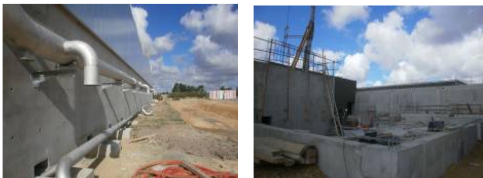
A gauche, le réseau de gaines en attente des ventilateurs qui permettront la maturation du produit par aération forcée.
